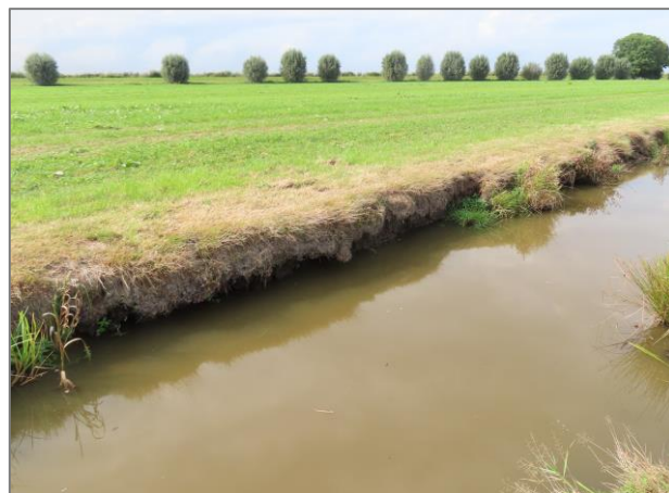
Afbeelding 2.2 | Veengrond kan aan de oevers afbrokkelen, wat versterkt zal zijn door graafactiviteit van kreeften. Waar het land hoger boven het water ligt kan dat steile oevers geven.
