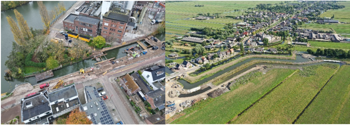
Figuur 10 foto links werk aan de Doorslagsluis en foto rechts knooppunt Polsbroek
