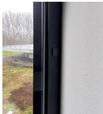
Bestaande bediening op verdiepingen 2 t/m 6 voorzien van blinddeksel
