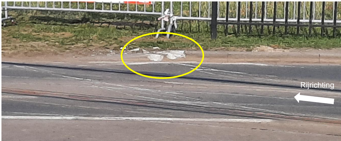
Foto 3: Beschadigingen in de trottoirband (in rijrichting gezien aan de rechterzijde van de ontsporingslocatie).
