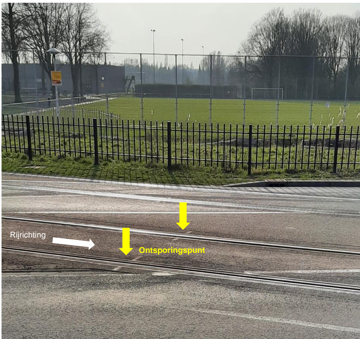
Foto 2: Ontsporinglocatie, gezien vanaf de rechterzijde (in rijrichting gezien).
